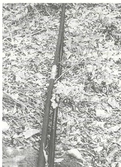
写真-5 ポリホースと耐圧ホース
