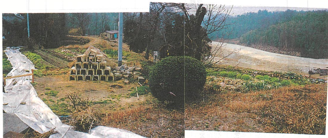
写真-5 明瞭な地すべり部の背後に発生したクラック (ビニールでカバー). クラックは約40m連続する (Bタイプ).
