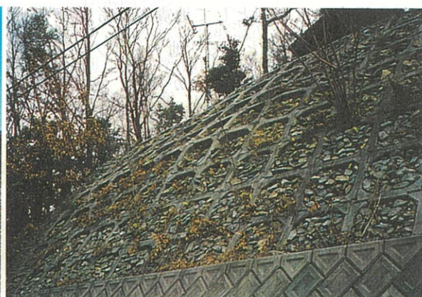
写真一九 PC 枠工のはらみ出し。これは道路の切土法面である。
