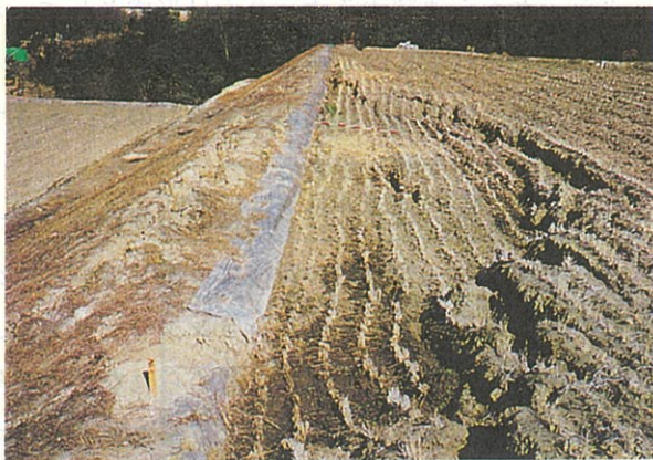
写真-1 圃場で発生した円弧すべり頭部 (Aタイプ).
