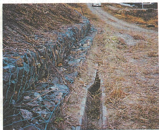
写真-4 同左末端部の圧縮変状.
