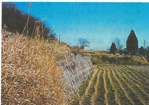
写真一八 ブロック積工のはらみ出し。
