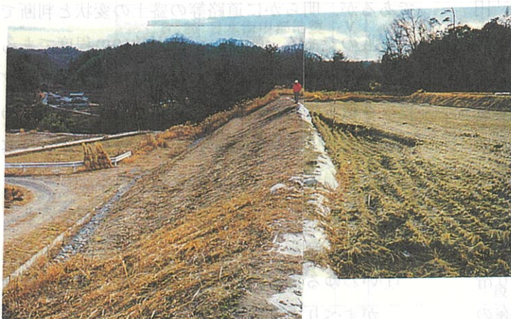
写真-3 同じく圃場で発生した円弧すべり (Aタイプ).
